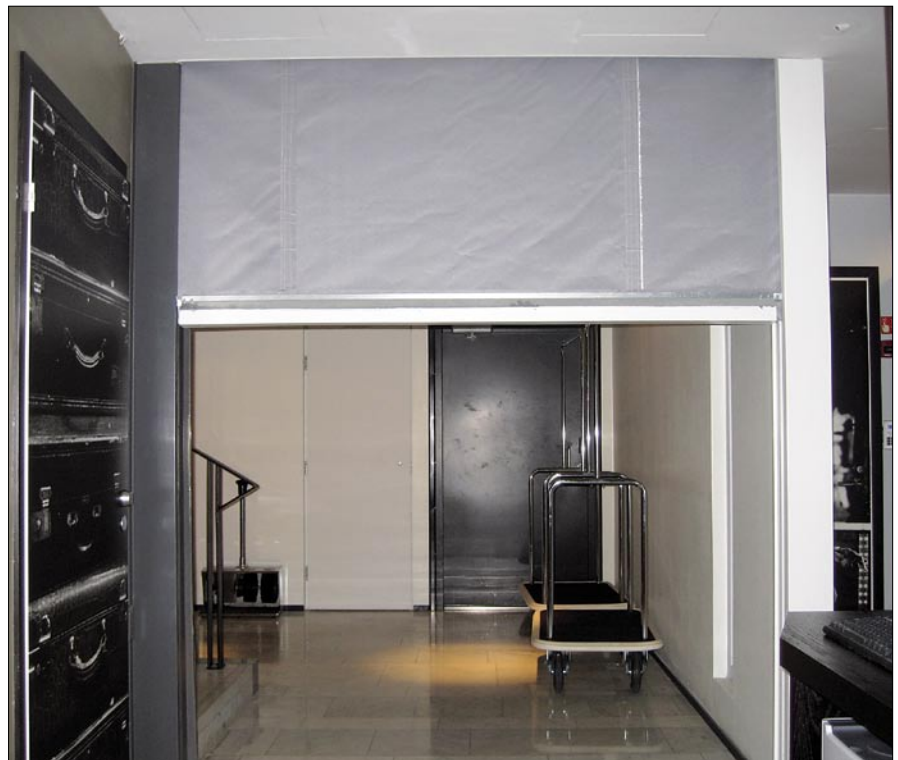
Rullautuva palo-ovi asennettuna hotellin porraskäytävään. Hotelli GLO, Aleksanterinkatu 40, Helsinki.
